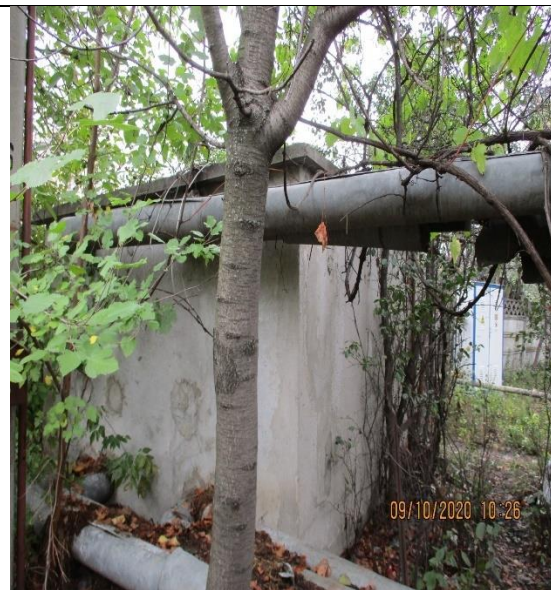
Conexiunea la rețeaua de gaz în imediata apropiere a corpului de clădire – punct termic
